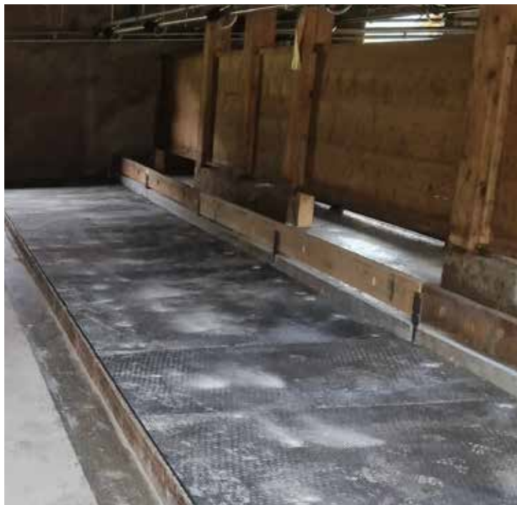
Die Barmen im Stall auf der Alp Tambo wurden an die Vorschriften des Kantons angepasst und entsprechend nun wieder allen Bestimmungen
