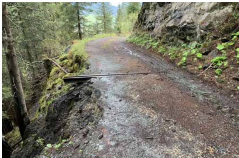
Verengte und beschädigte Fahrbahn durch talseitige Rutschung.
